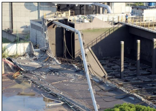
Figura 51 – Rompimento de tanque na ETE.
