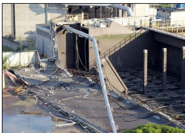
Figura 28 – Rompimento de tanque na ETE.
