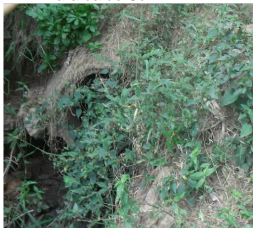
Figura 10 – Esgoto lançado in natura na galeria de águas pluviais no rio Paraíba do Sul.
