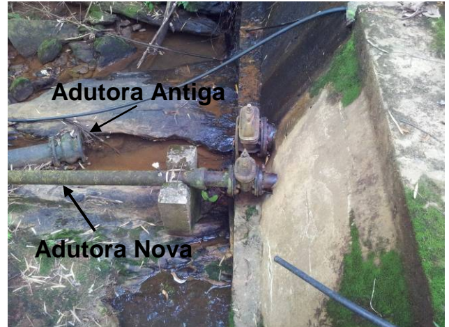
Figura 12 – Adutora nova de água bruta.
