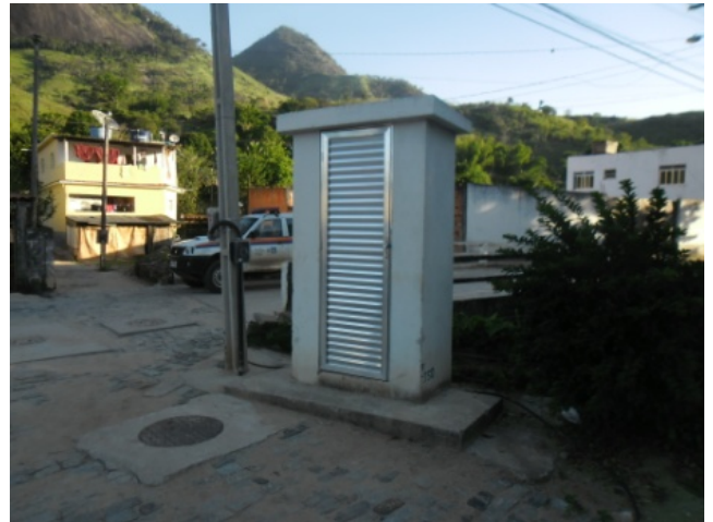
Figura 50 - Bombas de recalque e tampões da elevatória – 1S
