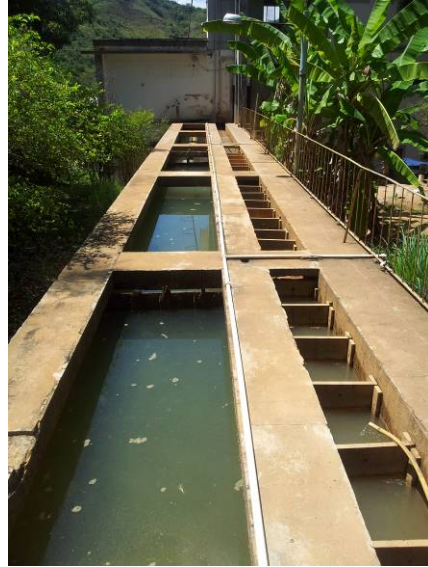
Figura 6 – Decantadores e Flocculadores.
