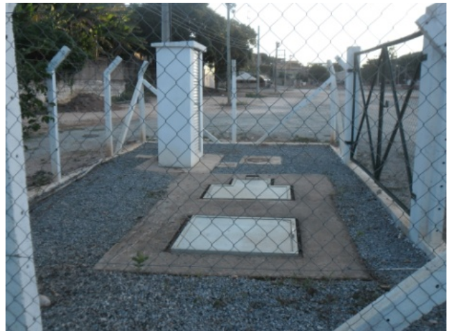
Figura 52 - Bombas de recalque e tampões da elevatória – 4S
