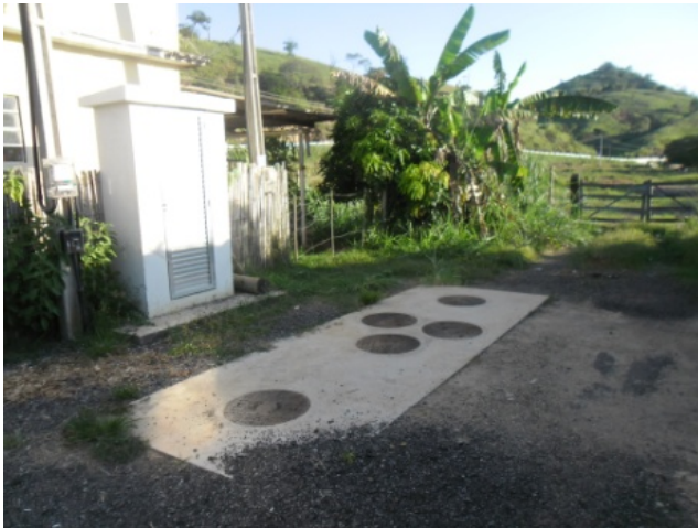
Figura 49 – Bombas de recalque e tampões da elevatória – 2SJ
