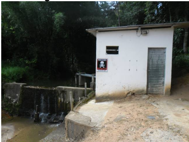
Figura 33 – Casa de bomba.
