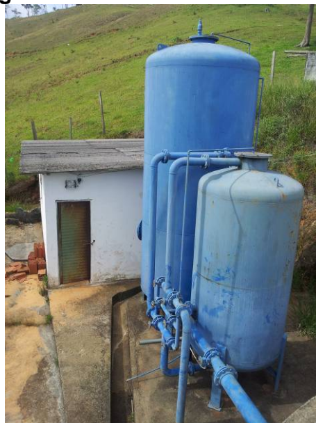
Figura 36 – Floco-decantador e filtro.
