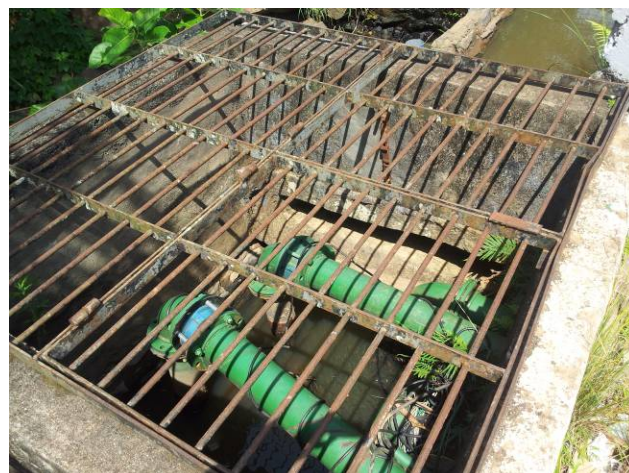
Figura 16 – Sistema de Bombeamento.
