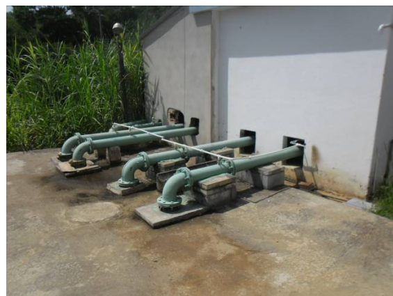
Figura 24 - Tubulações que recalcam a água tratada até o reservatório.
