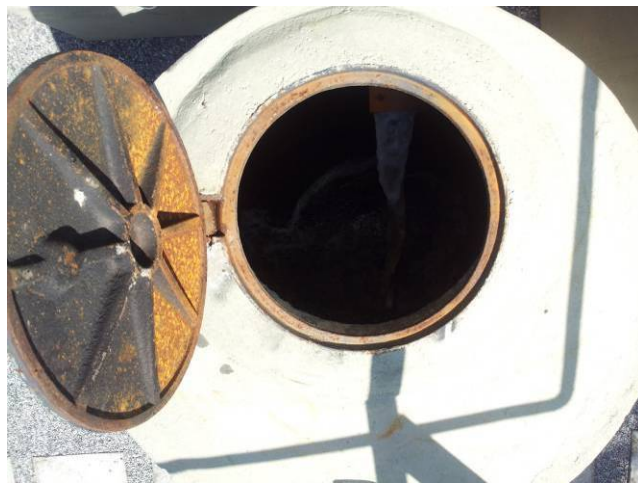
Figura 60 – Caixa de passagem dos efluentes tratados.
