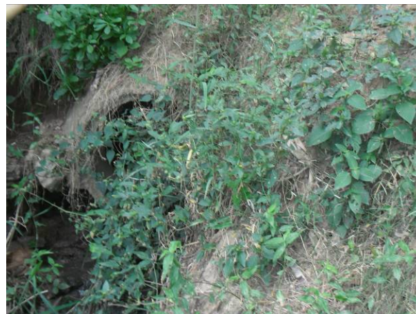
Figura 71 - Esgoto lanado in natura na galeria de guas pluviais no rio Paraba do Sul.
