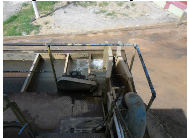
Figura 18 – Entrada de gua bruta.
