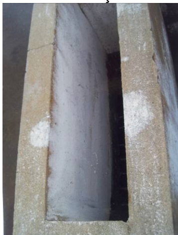
Figura 37 – Tampa de visita antes da intervenção.
