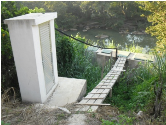
Figura 51 - Bombas de recalque e tampões da elevatória – 3S
