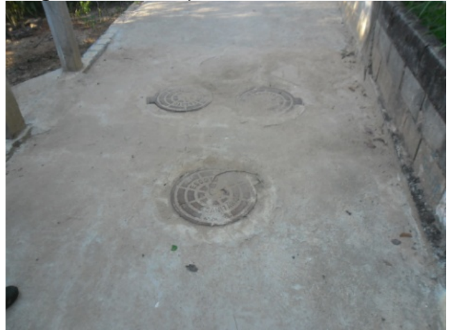
Figura 48 – Tampões da elevatória – 1SJ
