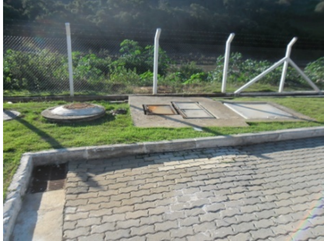
Figura 63 – Bombas de recalque e tampões da elevatória – Anta.
