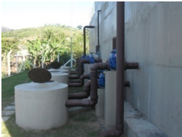
Figura 68 – Caixas de passagem de efluentes tratados
