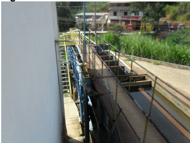
Figura 19 – Floculadores e decantador.
