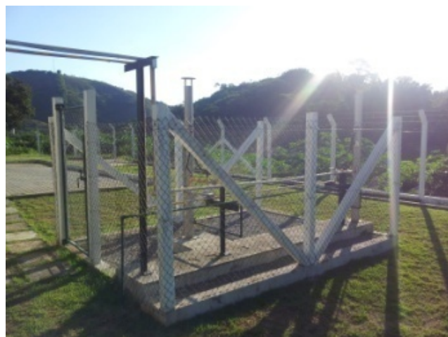
Figura 69 – Unidade de escape de gás.
