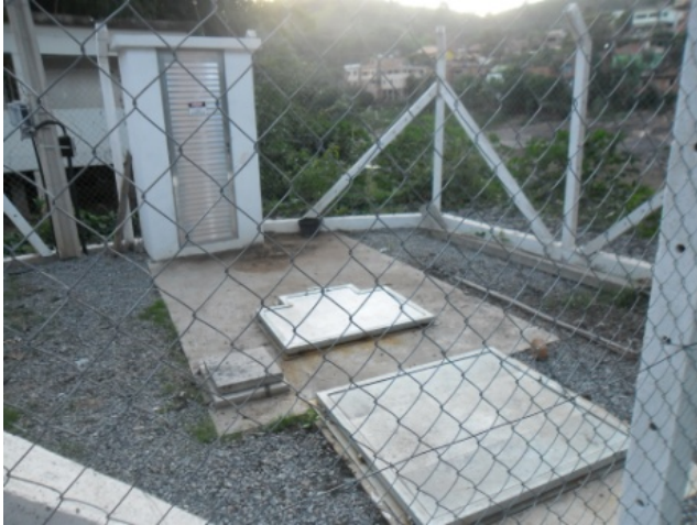
Figura 53 - Bombas de recalque e tampões da elevatória – Final de Sapucaia.
