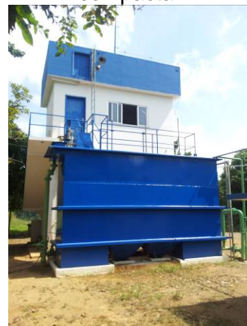
Figura 28 – Vista frontal de estação compacta.
