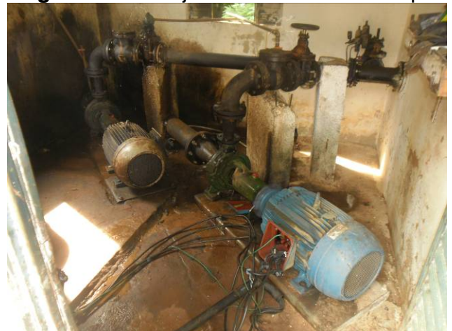
Figura 34 – Conjunto de bombas recalque.
